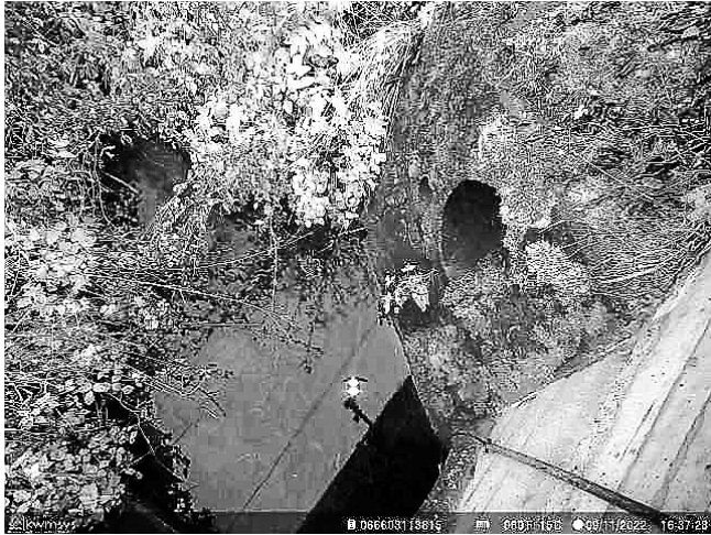
Eine neue Messstelle spiegelt sich auf der Wasseroberfläche Foto: Firma kwmsy
