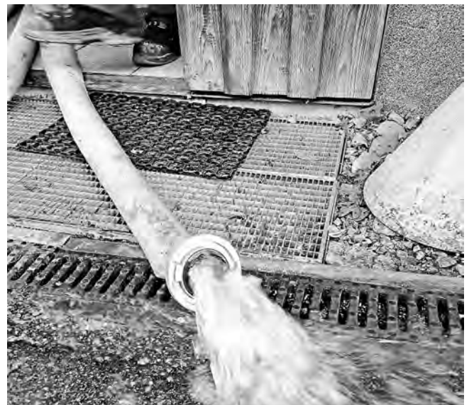
Das Auspumpen des Kellers nahm einige Zeit in Anspruch.
